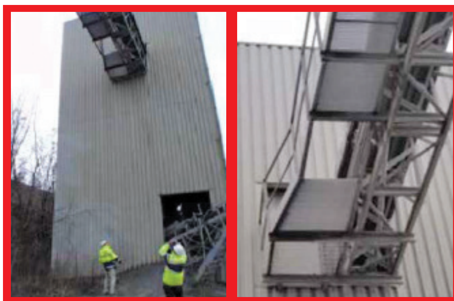
Smrteľná nehoda (nie na pracovisku CRH): Pracovník padol z výšky 14 metrov keď sa pod ním prepadla časť roštu podlahy. Upevňovacie skrutky roštu sa postupom času kvôli blízkemu vibračnému triediču uvoľnili.
