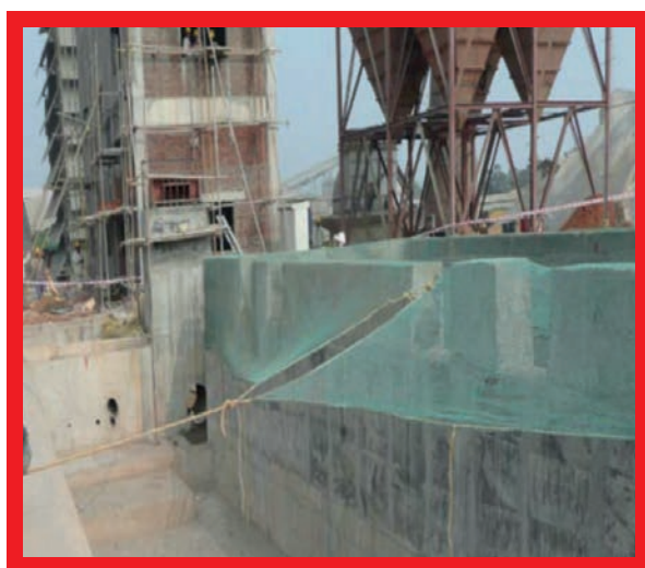
Smrteľná nehoda v roku 2011: Konštrukčný projekt: dodávateľ spadol pri prekračovaní múru počas budovania nadstavby.
